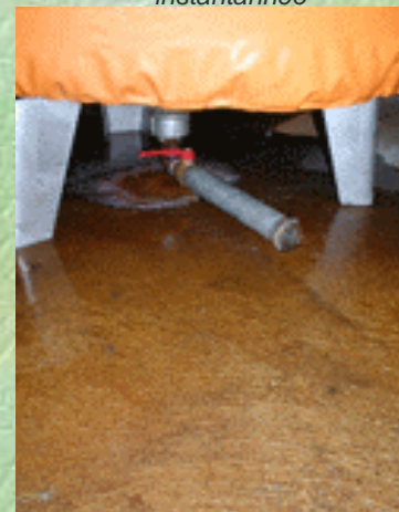
Purge de fond de ballon
