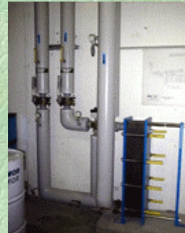
Production d'eau chaude sanitaire instantannée
